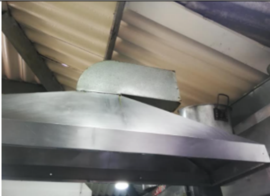
Fotografía No. 5: Campana sin sistema de extracción ni ducto instalado
