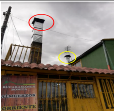
Fotografía No. 7: Ducto del área de asado (Rojo), Ducto del área de cocción y freído (Amarillo)
