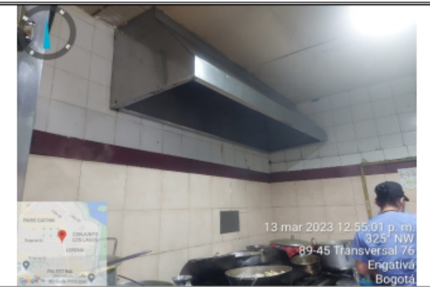
Fotografía No. 6. Campana de la estufa con plancha incluida
