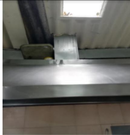
Fotografía No.4: Sistema de extracción y tramo del ducto de desfogue de la estufa de 5 puestos.
