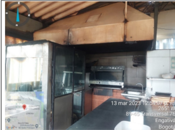
Fotografía No 3. Horno tipo trompo, parrilla que operan con leña como combustible y campana de las fuentes
